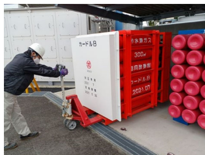
[ 水素カードル設置 ]
